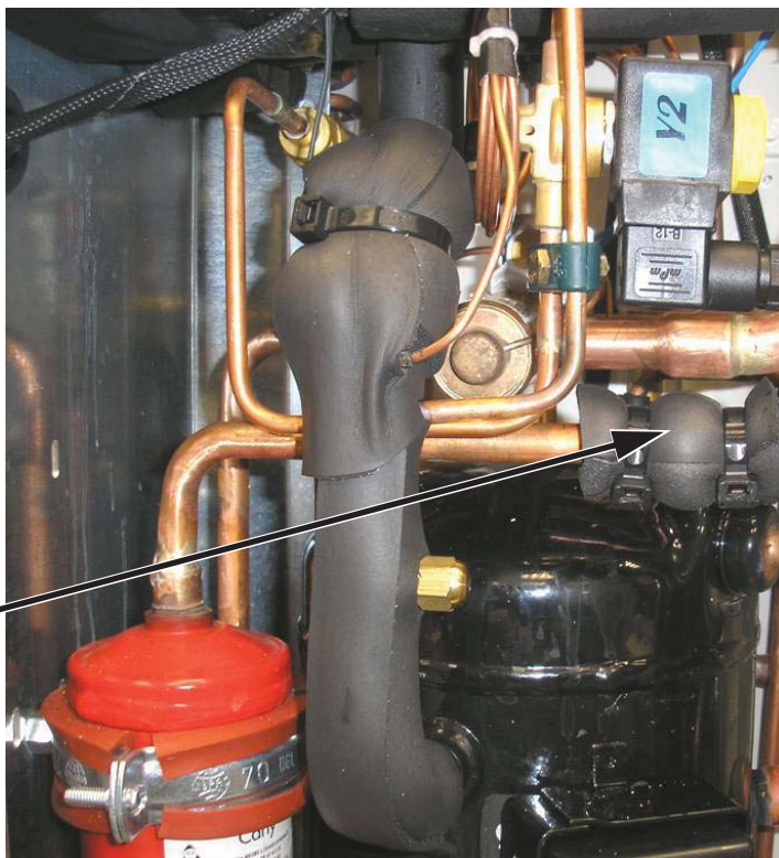
Sonde refoulement compresseur - S8 Température du fluide frigorigène en sortie du compresseur (sur J3)
