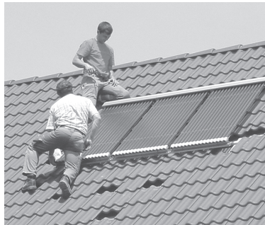
Solaranlage mit Röhrenkollektoren
